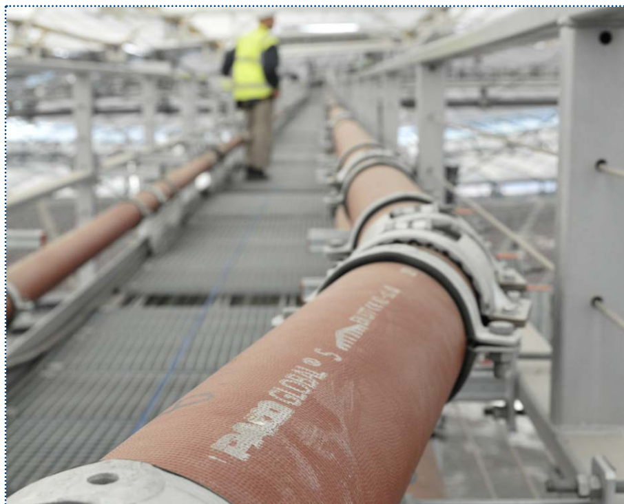
Fot. 4. System kanalizacji wewnętrznej Saint-Gobain PAM na Stadionie Narodowym
